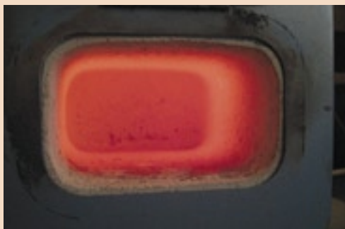
Pohled do rozžhavené pece
