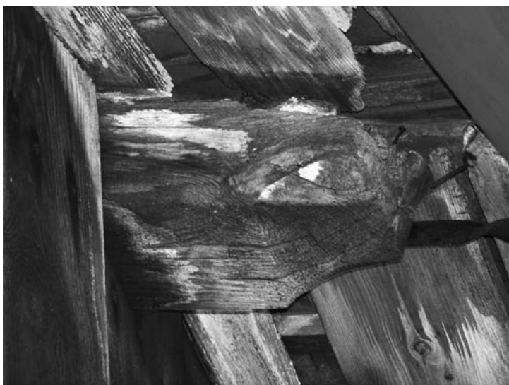
Obr. 4 Poškození krovu způsobené zatékáním po krokách
